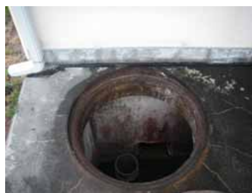
マンホ - ル蓋の劣化状況
