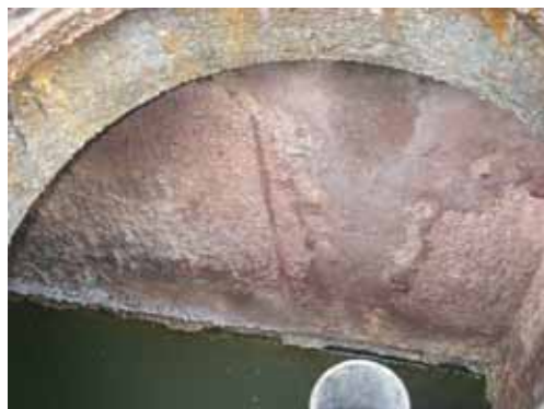
コンクリ - トの劣化状況
