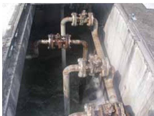
配管の劣化状況
