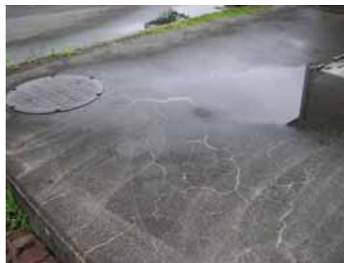
水槽頂版のひび割れ状況
